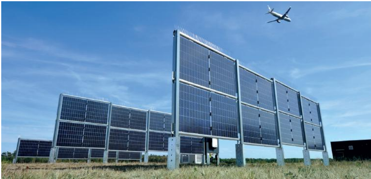
Abbildung 68. Teststrecke des Photovoltaik-Bahnsystems auf dem Gelände des Frankfurter Flughafens (Fraport, ohne Jahresangabe)
