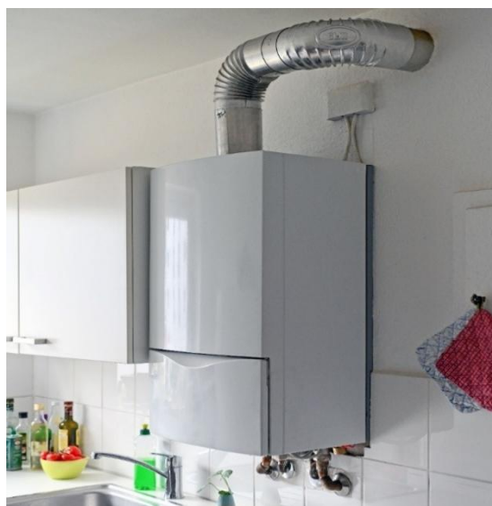
Abbildung 93. Gastherme als Übergangslösung für die Wärmeversorgung
