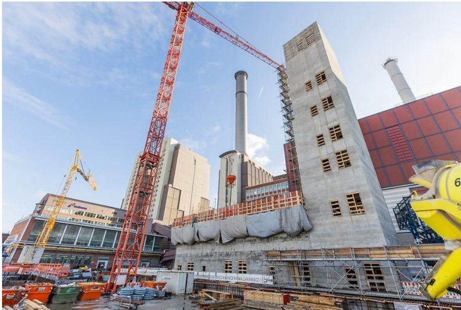
Abbildung 103. Kohleersatzprojekt HKW West
